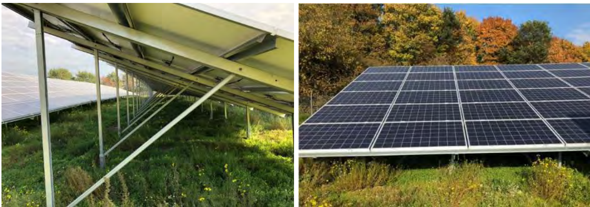
Abbildung 5: Beispiele für Module einer Photovoltaik-Freiflächenanlage des selben Vorhabenträgers aus Emkendorf (Quelle: SolarWind Projekt GmbH, Hamburg)
